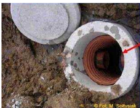
Ryc.17.2.1c. Przykład sytuacji jakich należy unikać: pułapka powstała podczas budowy drogi, fot. M. Sołtysiak.
