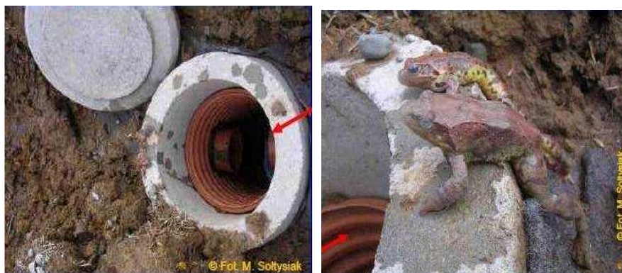
Fot. 2. Przykład sytuacji jakich należy unikać: pułapki powstałe podczas budowy drogi, płazy utopione w studzience odwodnieniowej, fot. M. Sołtysiak.
