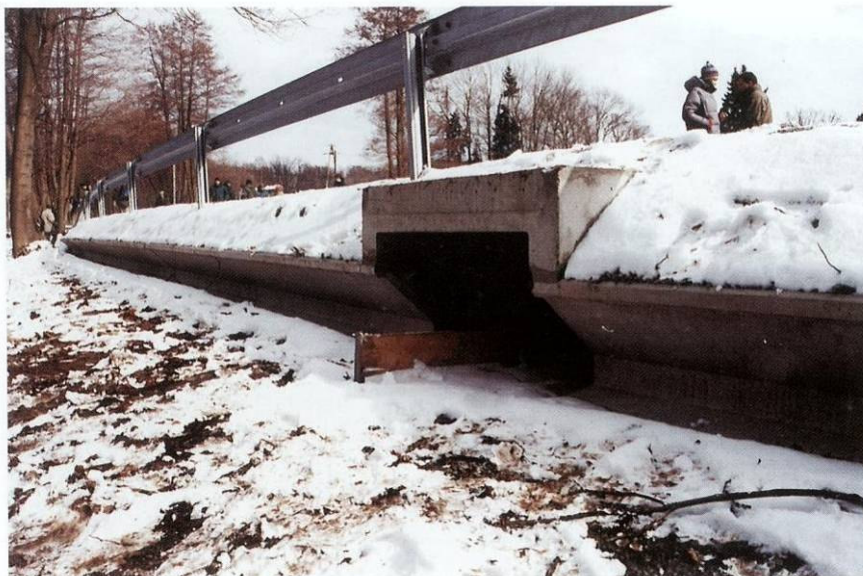
Zdjęcie 2 – Przejście dla płazów z profilowanych prefabrykatów betonowych [Jędrzejewski W., Nowak S., Kurek R. Mysłajek R., Stachura K., Zawadzka B.; „Zwierzęta a drogi” - Zakład Badania Ssaków PAN, Białowieża 2006]
